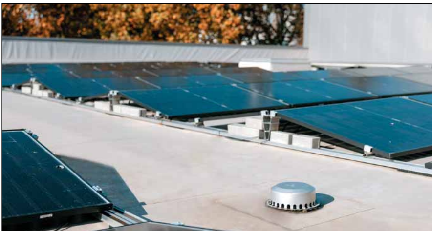
KWS nutzt das Dach auch zur Energiegewinnung mit PV.
