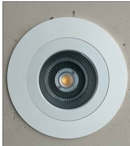
Die neuen LED-Downlights von Emslicht ließen sich mit geringem Aufwand einbauen, ohne dabei den Sichtbeton zu beschädigen. In der Lichtfarbe 3.000 K geben sie besonders warmes Licht ab.
